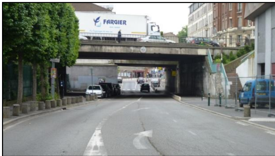
Illustration 104. Passage sous la RD86 : cheminement piéton très étroit
