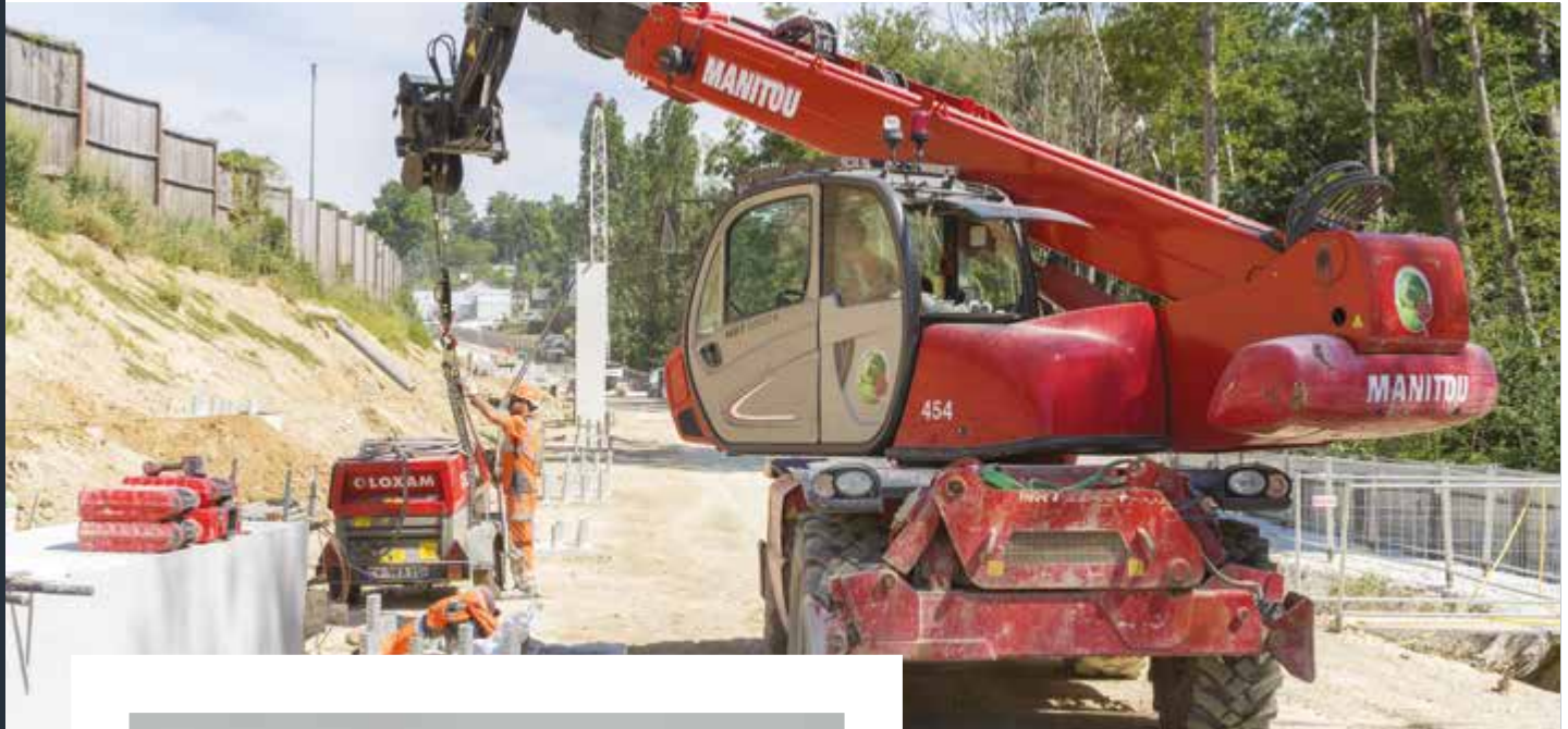
Réalisation des piliers soutenant la plateforme du tram dans le parc du Séminaire à Morsang-sur-Orge
