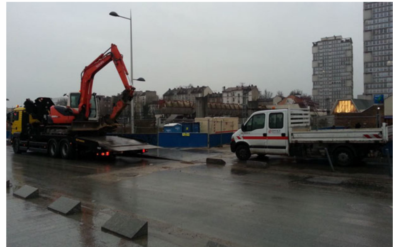
Figure 238 : Travaux de réseaux au droit de la gare RER de Choisy-le-Roi Source : SNC-Lavalin, Février 2015
