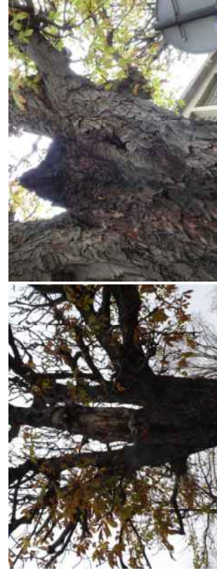
FIGURE 17 ET 18 : BRANCHE CASSEE (A GAUCHE) ET CAVITE (A DROITE) - @EGIS 2020
