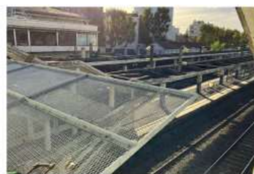
Etanchéité des abris
