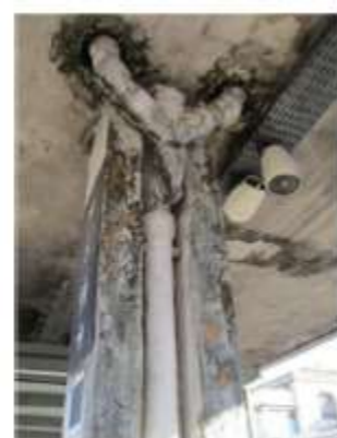
Evacuations des eaux pluviales
