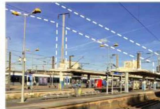
Alimentation sur le quai 3j
