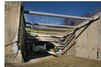
52 – Exemple de travaux d'ouvrage en parois berlinoises tirantées (Ouvrages Parc de la Mairie – Piver)
