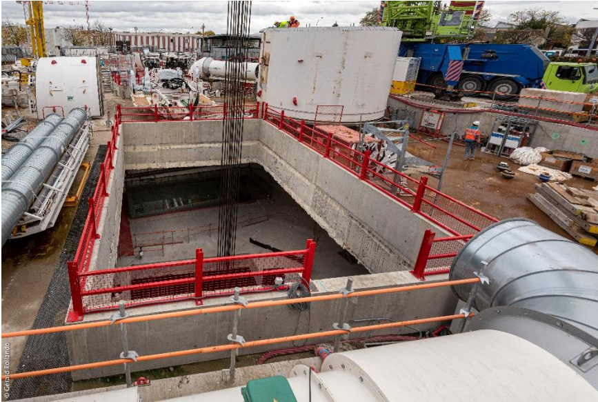
Puits « Bel-Air » à Vitry (94)
