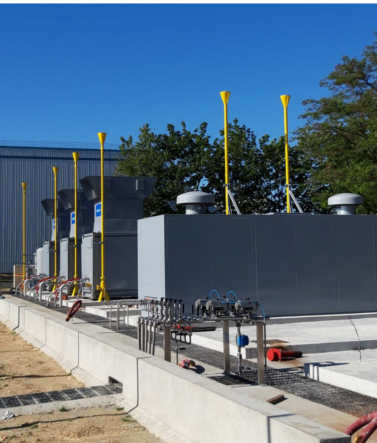
Travaux d'une station de compression biogaz au centre bus de Massy (GNV)
