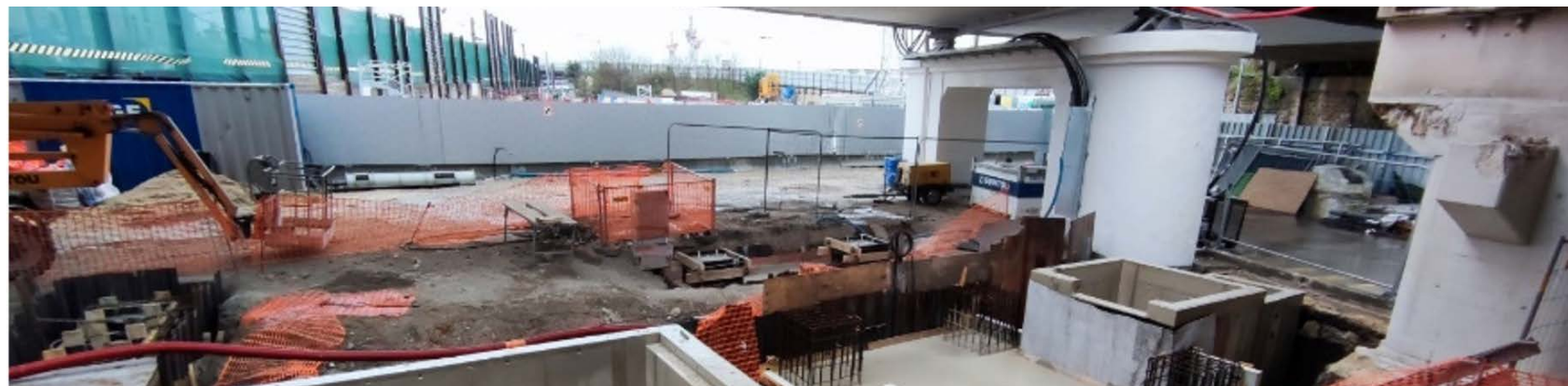
Chantier du Bourget. Travaux d'interconnexion avec le Grand Paris Express - SNCF Réseau
