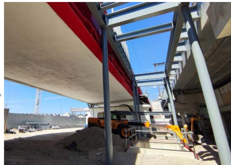
Chantier du Bourget. Travaux d'interconnexion avec le Grand Paris Express - SNCF Réseau
